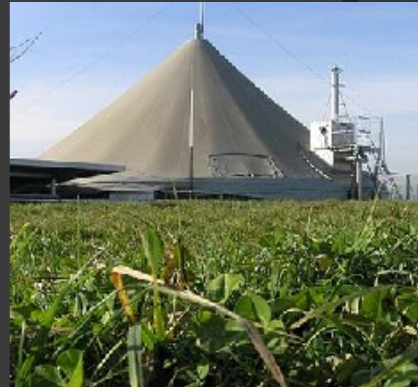
Метантенк биогазовой установки
